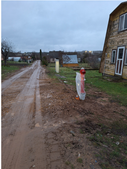
4 pav. Įrengtas priešgaisrinis hidrantas SB „Pavasaris“
