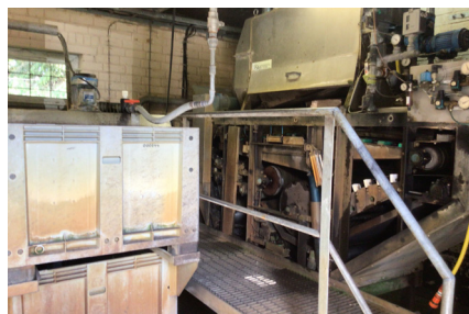
1 pav. Esamos įrangos būklė
